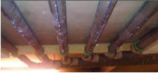
Ilustración 6.5 Condensación en tuberías de agua fría
